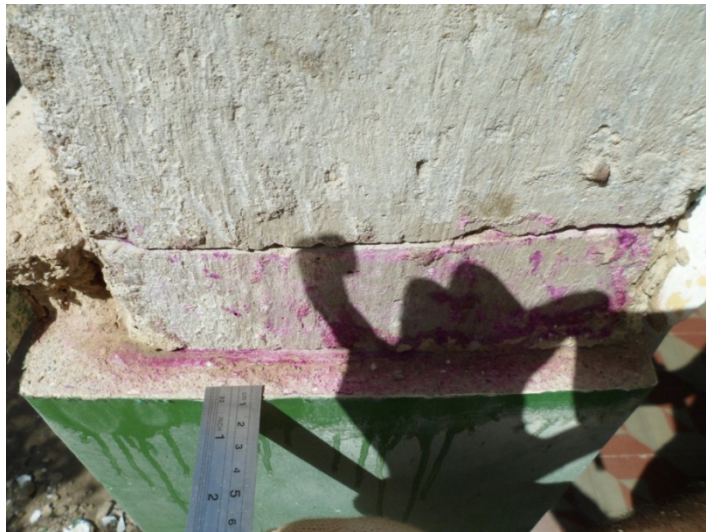
Figura 7 – Pilar DREC – Frente de carbonatação de 10mm. Só atingiu a argamassa.
