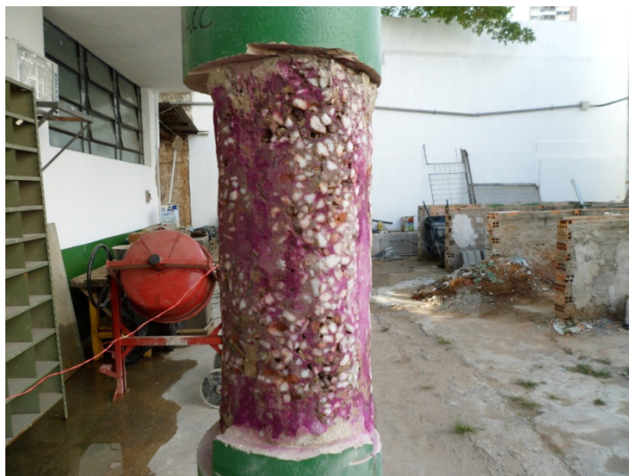
Figura 9 – Pilar LAB.DACC – Frente de carbonatação de 20mm. Só atingiu a argamassa.
