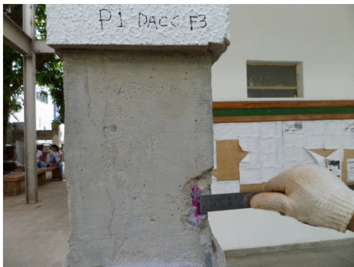
Figura 8 – Pilar DACC – Frente de carbonatação de 20mm no concreto. Mas não atingiu a armadura.
