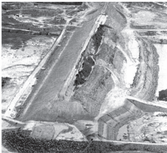
Figura 5. Vista da Ruptura do Talude de Montante da Barragem de Açú.
